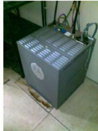
Estação Base Equipamento rádio
