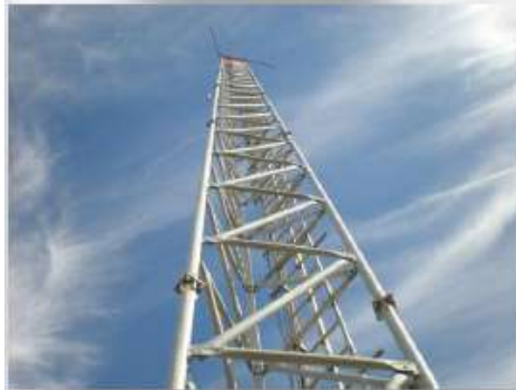
Torre (20-30m) com 2 ou 3 antenas
